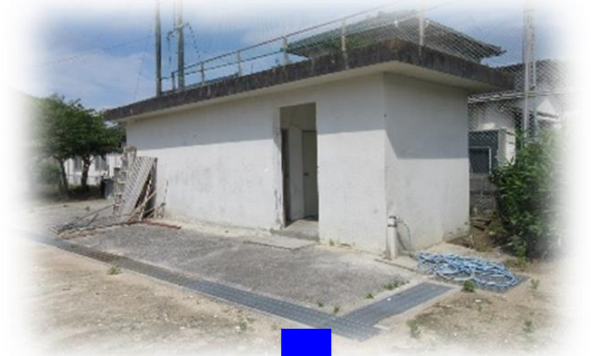
老朽化した屋外トイレ
