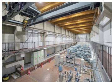
水密化されたポンプ棟
