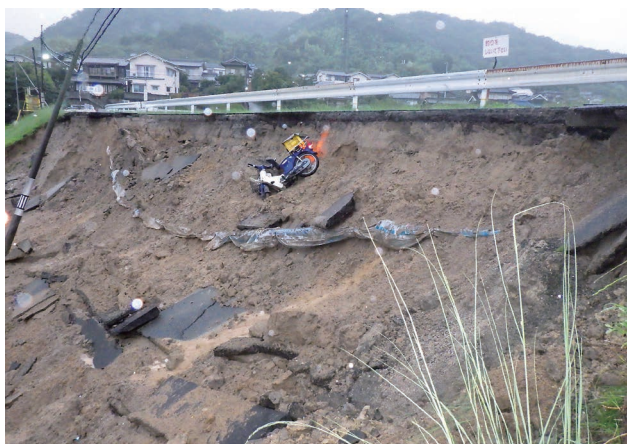
▲ 大池(栗原町)の歩道が崩れ、バイク乗車中の男性が重傷。水道管が露出しました。
