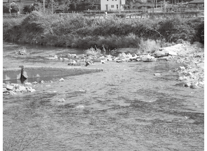
御調川取水堰の破損
